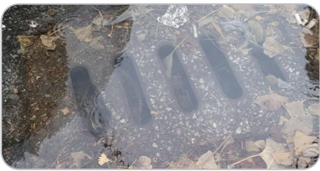
빗물받이 막힘, 지하공간 침수 등
