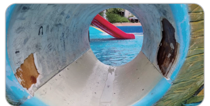
물놀이 시설 파손
